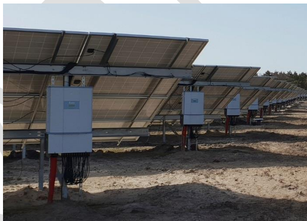
Figur 6. Eksempel på inverterer der sidder under solpanelerne.
